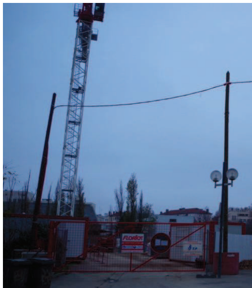
■ Le bâtiment de la future bibliothèque est en cours de construction dans la continuité de la rue Monod, prolongée dans le cadre du projet urbain. Photo Alexandre Vieira
